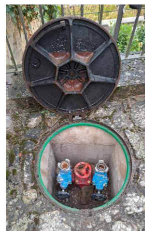
Hidrante de Incendios con dos racores Barcelona de 70 mm tres llaves de cierre de volante, una general y las otras para cada toma.
