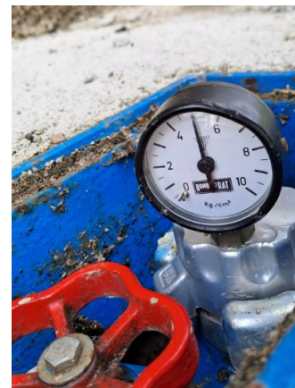
Medición de presión estática en una boca de riego con llave de cierre de volante.
