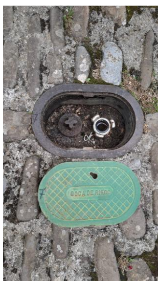
Boca de Riego con salida racor Barcelona de 45 mm y llave de cierre de estrella.
